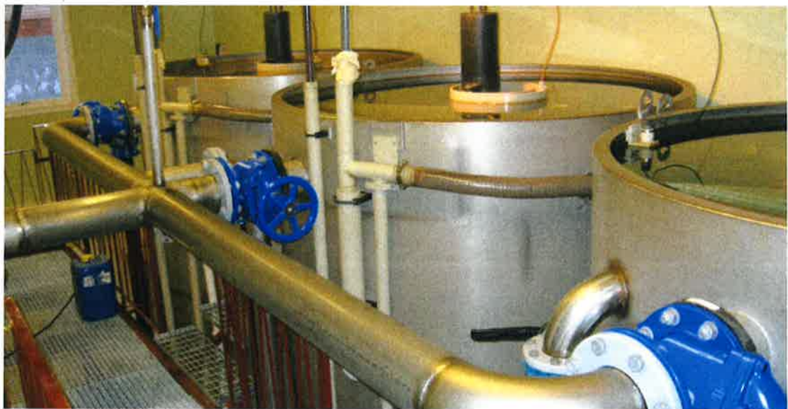
Figur 7 Sandfiltre i Leirfjord vannverk
