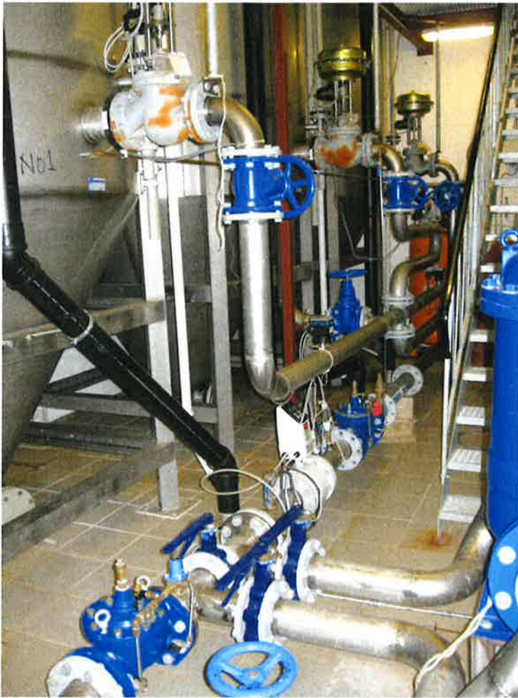
Figur 8 Bunn av sandfiltre i Leirfjord vannverk
