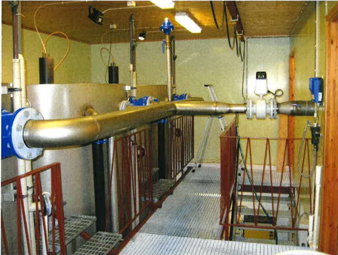
Figur 3 Sandfiltre i Leirfjord vannverk
