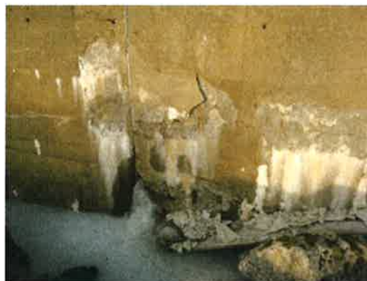
Figur 6 Sprekker i demning Simsøvatnet
