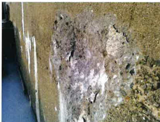
Figur 5 Sprekker i demning Simsøvatnet
